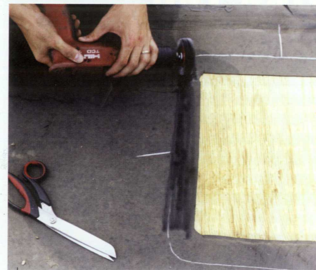
Het door het uitgesneden monster ontstane gat wordt gerepareerd. Voor de kwaliteit van de overlapverbinding wordt de oude EPDM-dakbedekking opgeruwd met een powerfile.
