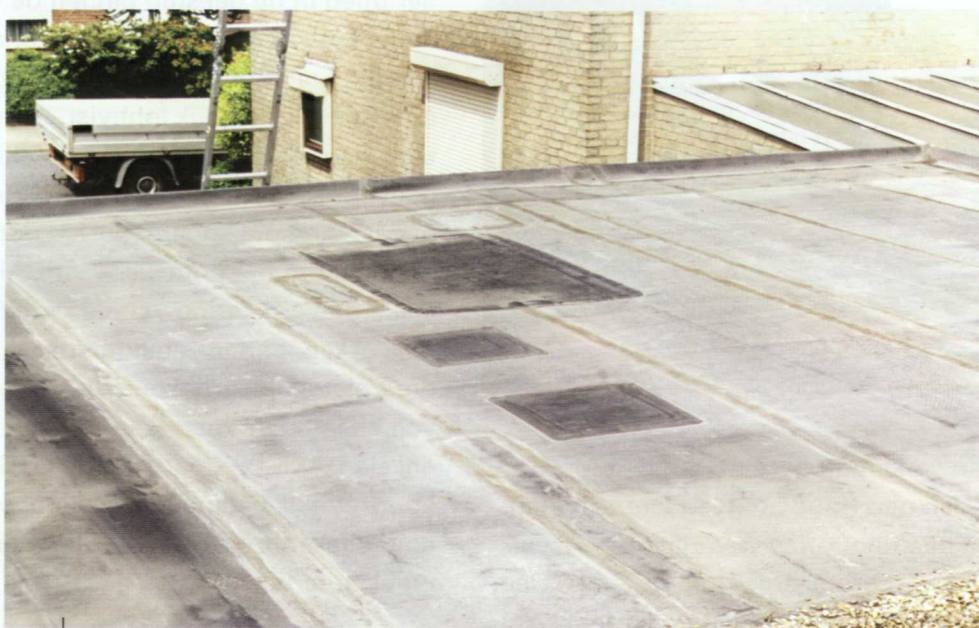
Overzicht van het 40 jaar oude dak.
